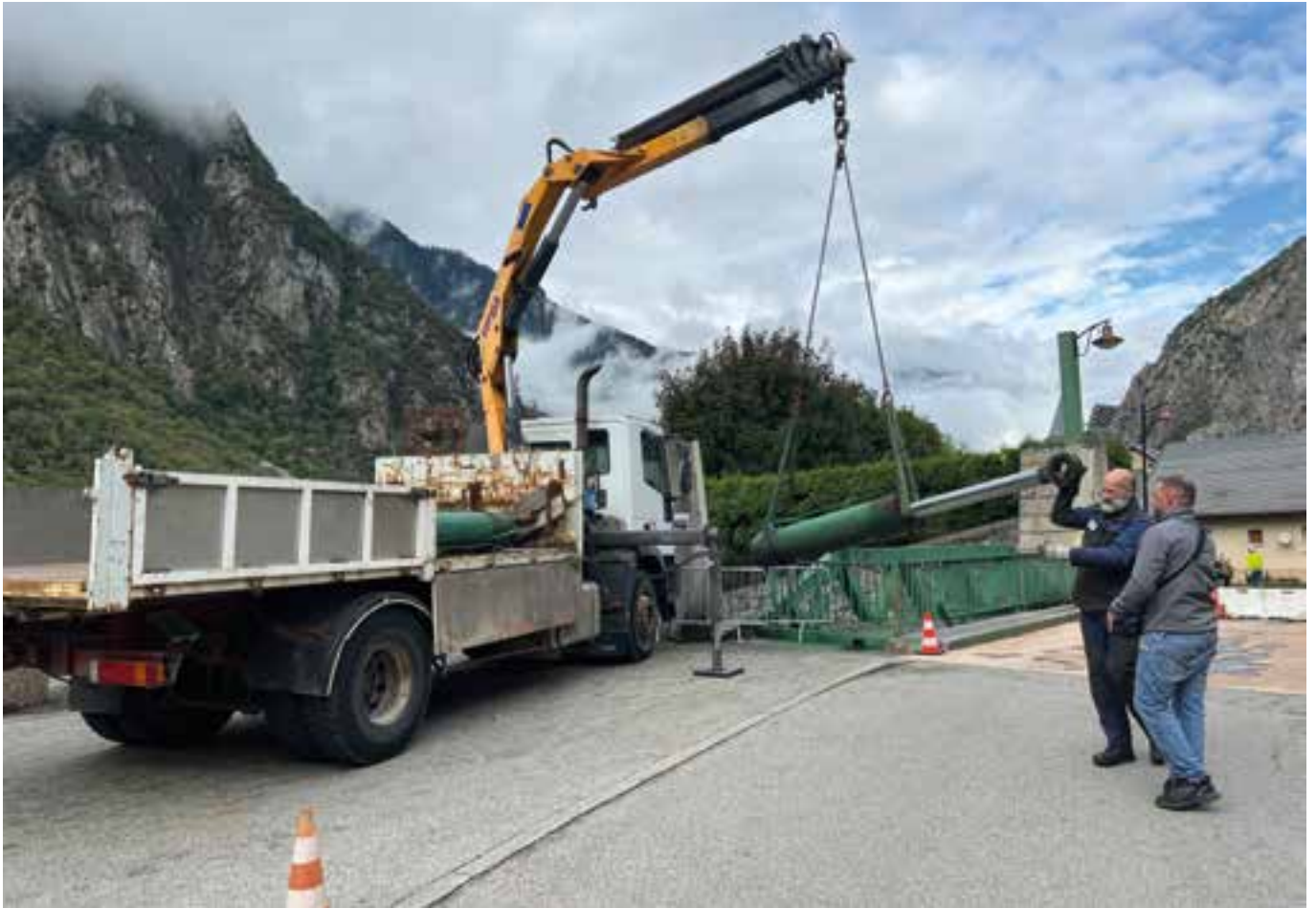
Démontage des vérins et transport à l'atelier. Travaux réalisés par les établissements Mille.
